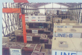
県企業局 米倉山電力貯蔵技術研究サイト
